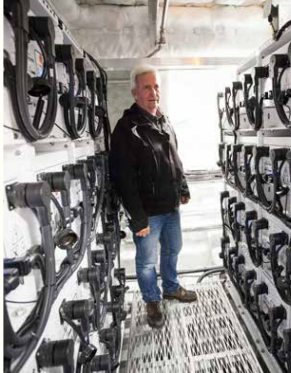
KRAFTPAKKE: Geir Haaland fra Norled viser fram batterirommet i «Ampere». Foto: Bård Ek
